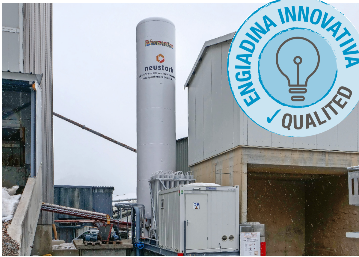
Schlank und rank: Die Neustark-Speicheranlage zur Reduktion von CO 2 in Recyclingbeton auf dem Werksgelände der Montebello AG in Pontresina mit Silo und Technikcontainer. Dazwischen der Verdampfer. Fotos: Jon Duschletta
